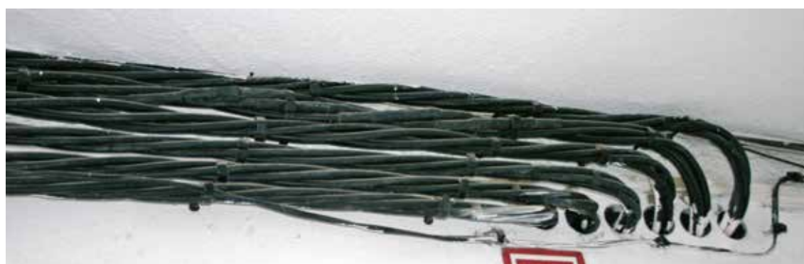
Cables trenzados tipo AL POLIRRET CPRO en redes posadas sobre fachada.
